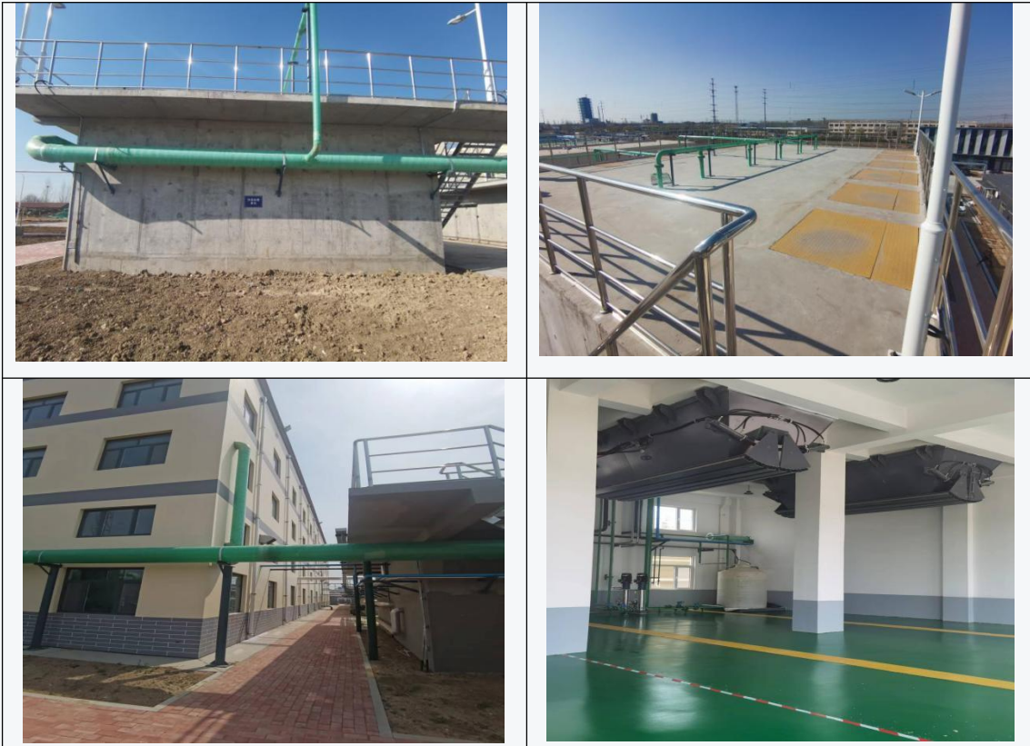
图 4.1-5 废气收集管路
