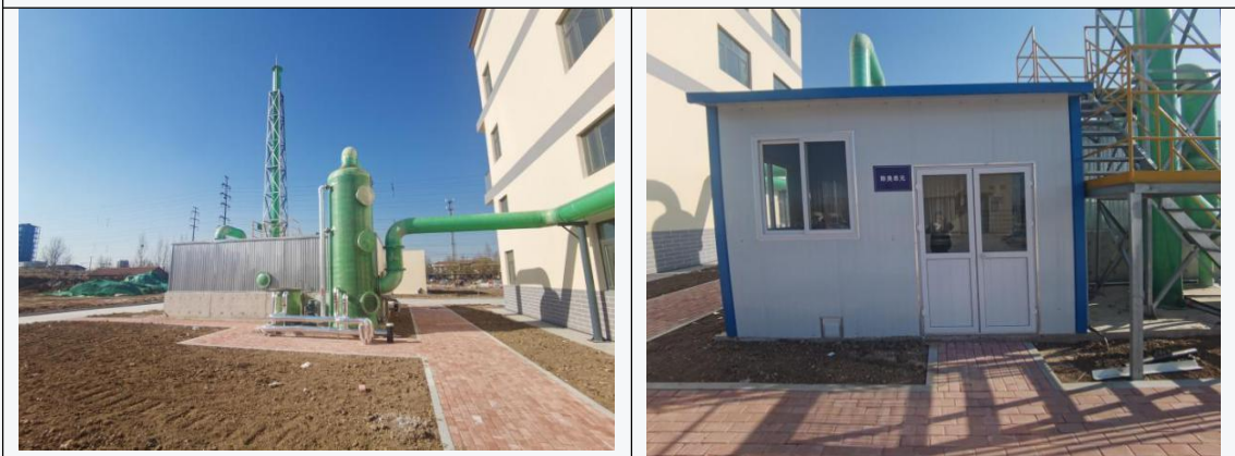
图 4.1-6 废气处理装置
