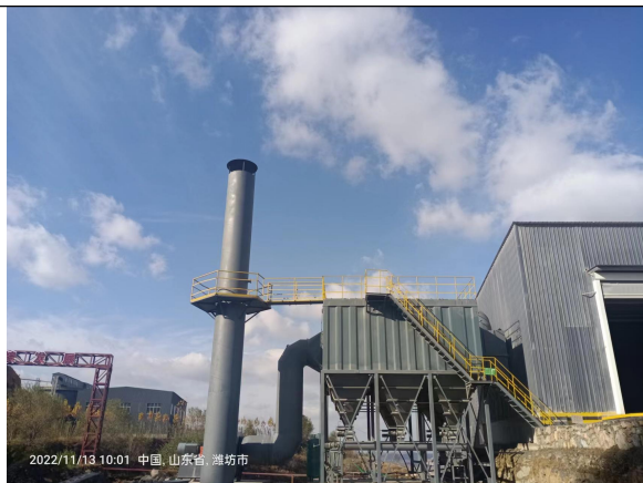
排气筒+布袋除尘器
