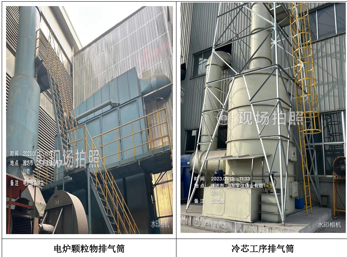
图 4.2-2 主要工序排气筒
