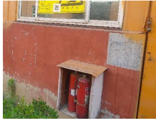
危废库灭火器
