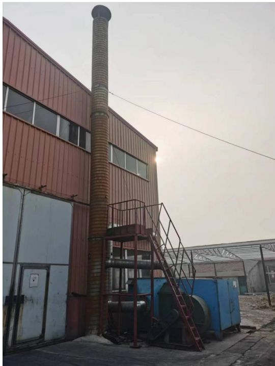
压延车间废气排气筒 P7
