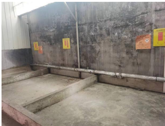
危废库防渗及分区标志
