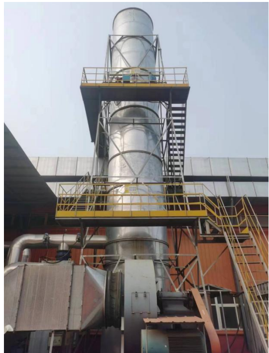
硫化车间废气排气筒 P4
