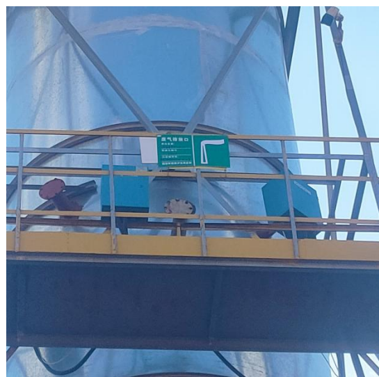
废气排放口 P4 标识 (DA004)
