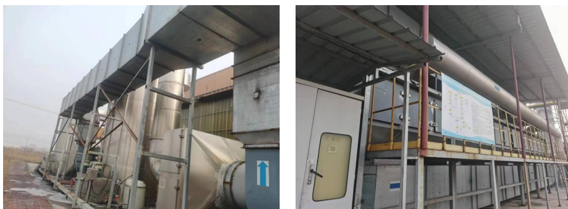
密炼车间废气处理设施
